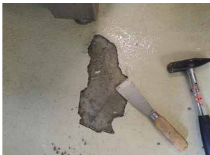
Typické poškození způsobené vztlínající vlhkostí
